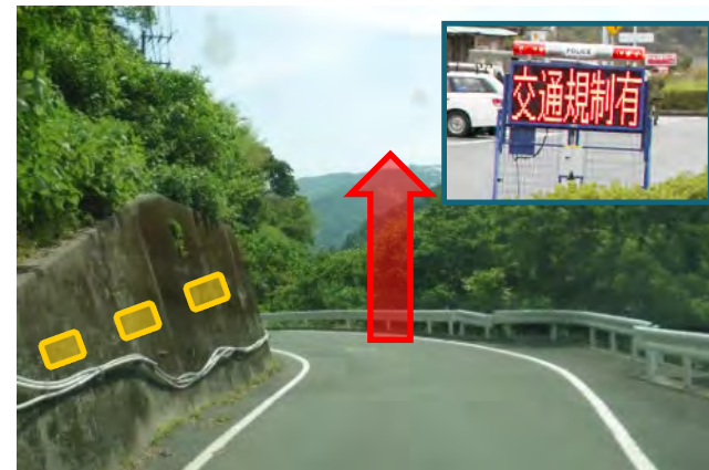
電光標識、反射材等の設置により安全な避難を確保
