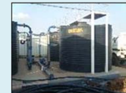
生活雑排水 貯水処理システム × 1
