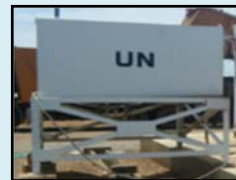
発電機用燃料タンク × 8
