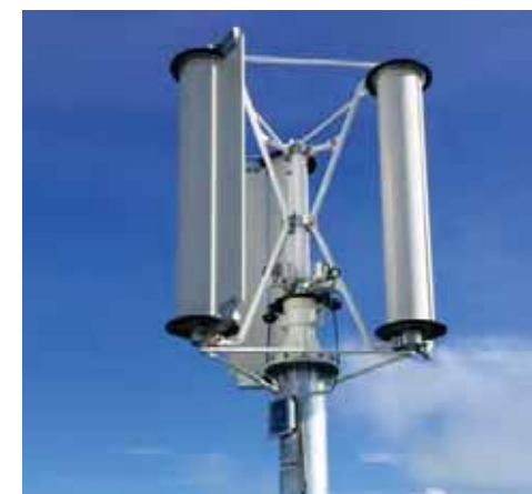
沖縄で稼働中の1kW実証機
