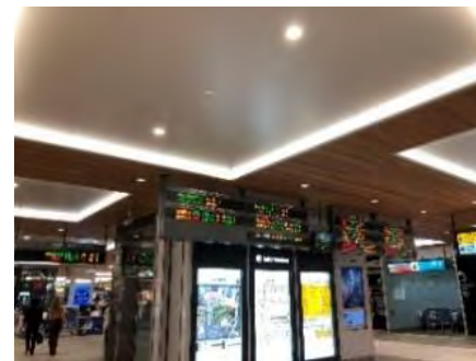
照明設備のLED化
