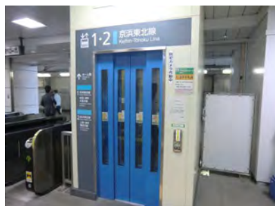
エレベーター
