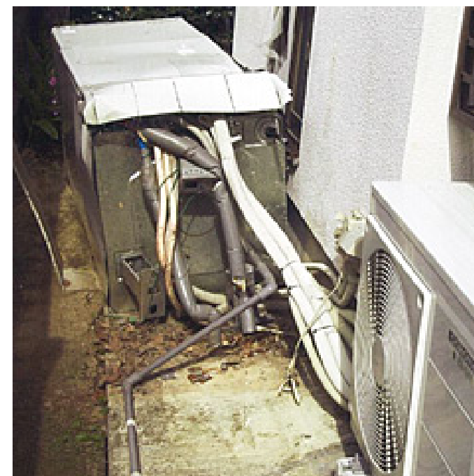
【熊本地震で転倒した電気給湯機】
