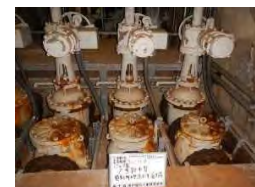
青函トンネル排水設備
