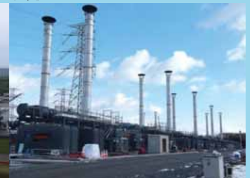
南早来発電所1号機～72号機 出力：7.4万kW
