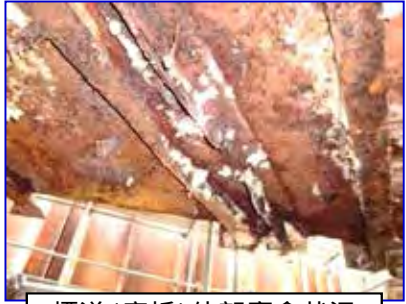
煙道(底板)外部腐食状況
