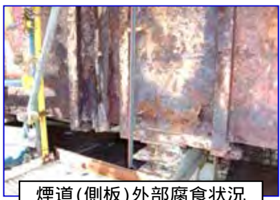
煙道(側板)外部腐食状況
