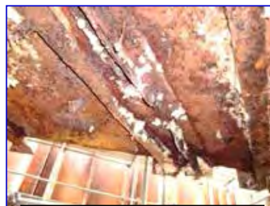
煙道(底板)外部腐食状況
