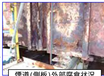
煙道(側板)外部腐食状況
