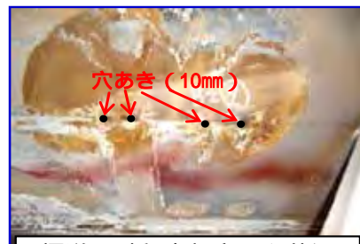
煙道(天板)内部穴あき状況
