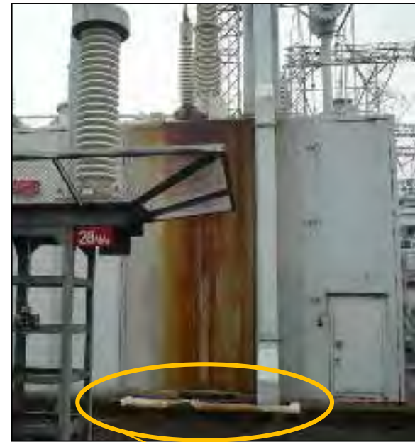
変圧器漏油の事例
