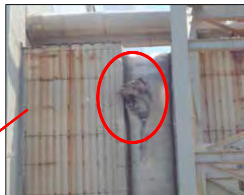
伸縮継手の損傷事例
