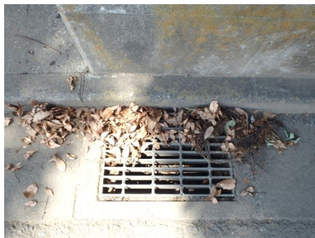
台風による集水桝詰り
