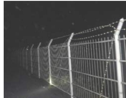
台風によるバーブドワイヤー破断
