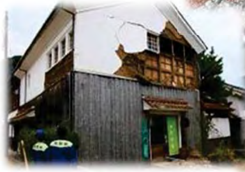
漆喰壁の崩落等の被害があった 白壁土蔵群の赤瓦三号館
