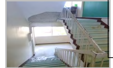
校舎階段裏のモルタル一部 (約80kg) が落下
