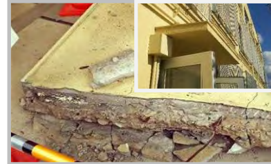
校舎出入口の庇 (約800kg) が落下
