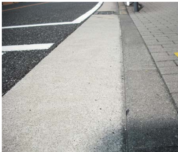
段差 2 cm の歩道。車いすなどの移動に支障(条例施行前)
