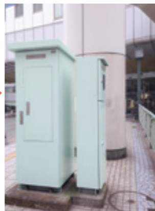
サポーター活動により、落書きが消された状態(解決後)
