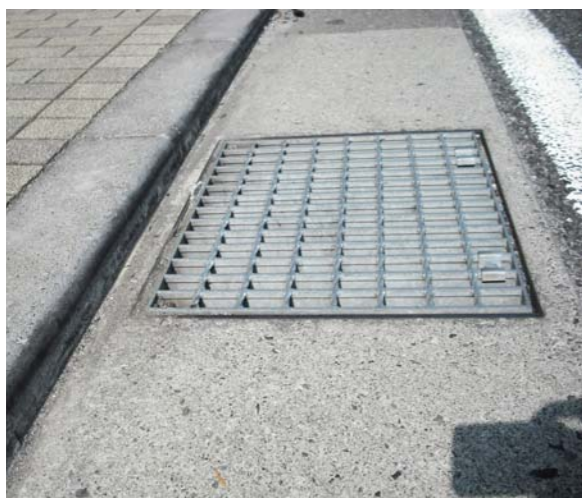
目の粗い排水溝の蓋。白杖やハイヒールなどが隙間に落ち込みやすく危険(条例施行前)
