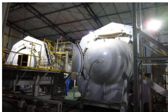
移動式廃棄処理設備
